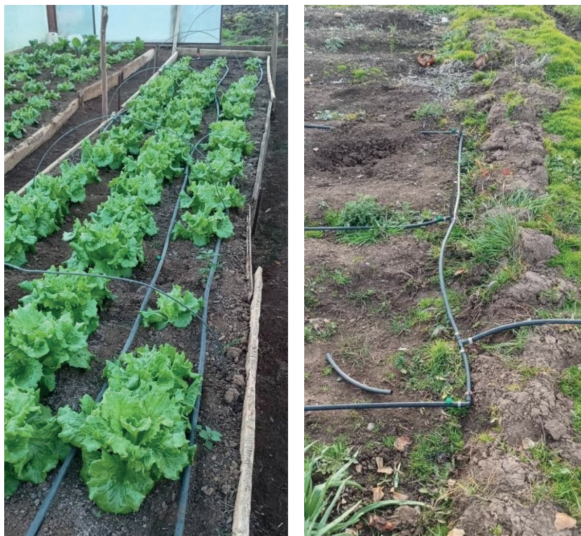
Figura 19. Ejemplo de sistema de riego instalado.
